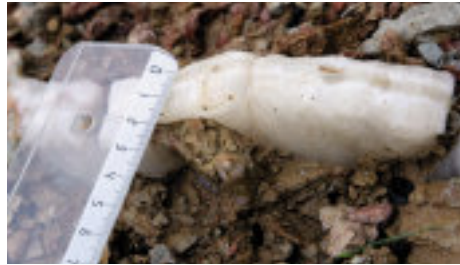
Des petites veines de gypses à l’origine des déformations de la chaussée.
